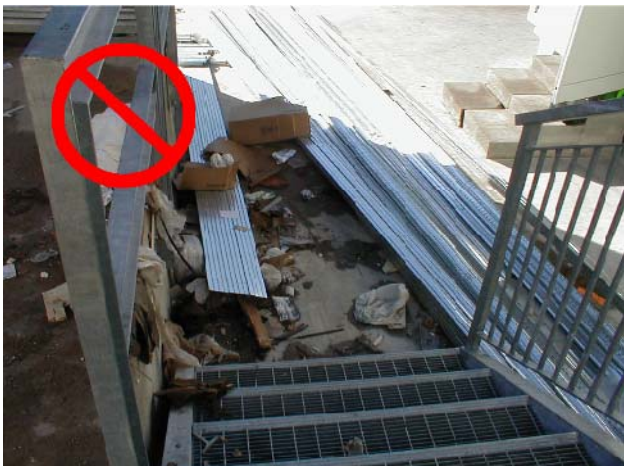
Scale ostruite da materiali
