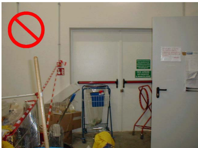
Vie d'emergenza ostruite da materiali
